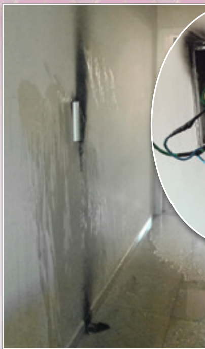
Cuadro eléctrico después del incendio
