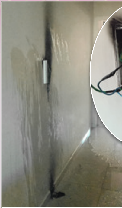
Cuadro eléctrico después del incendio
