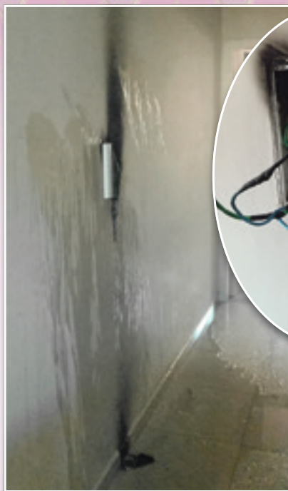
Cuadro eléctrico después del incendio
