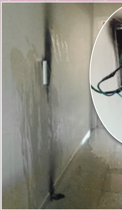
Cuadro eléctrico después del incendio
