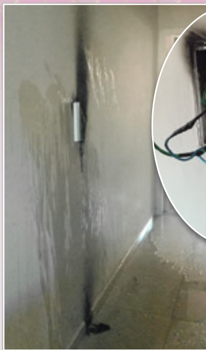
Cuadro eléctrico después del incendio
