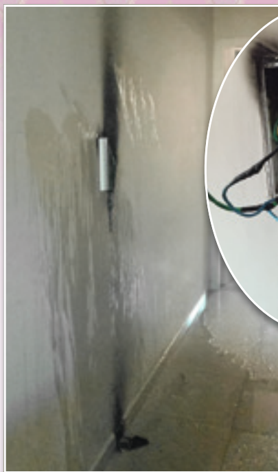
Quadro elettrico dopo l'incendio
