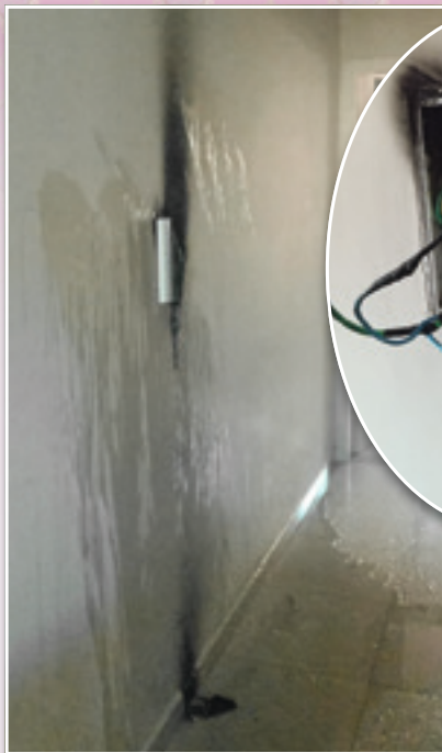
Caixa de luz após o incêndio
